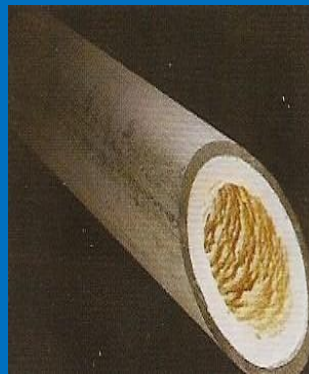
Ketelsteen in een leiding.
